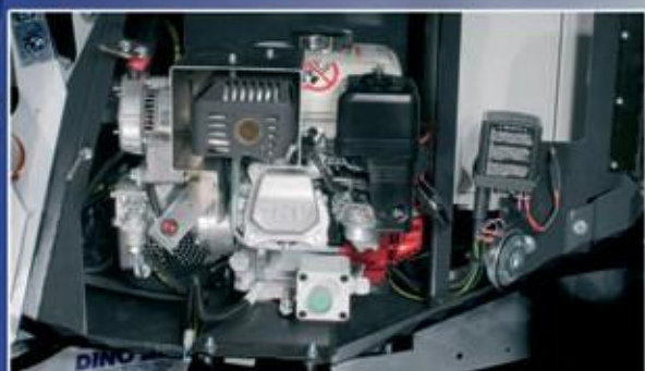
Standardausstattung mit Benzinaggregat – Antriebskraft auch ohne Netzstrom.
